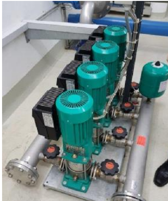
Abbildung 2: Druckerhöhungsanlage zur Versorgung der Zone 3
